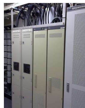
《無線回線制御施設》
